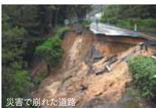
災害で崩れた道路
