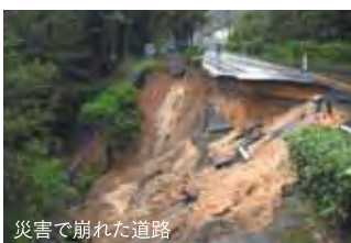
災害で崩れた道路
