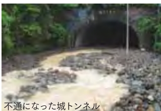
不通になった城トンネル
