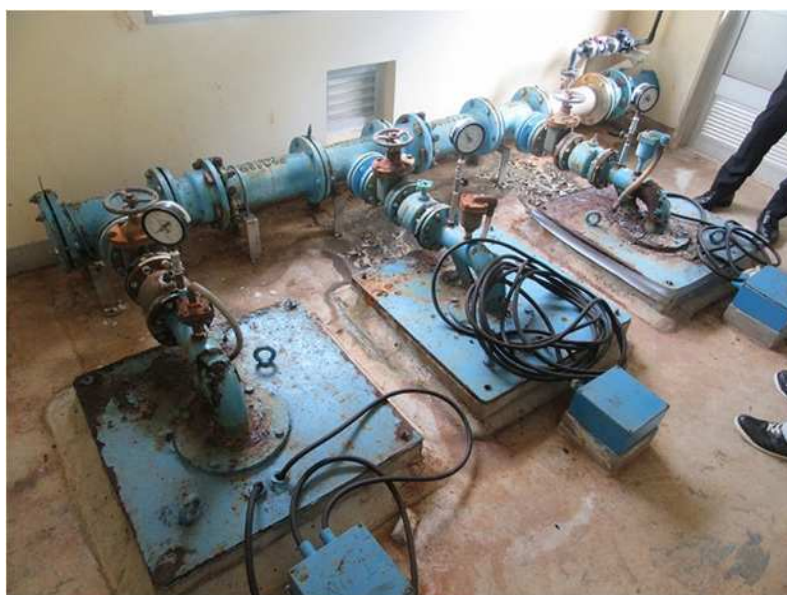
<写真－送水ポンプのようす>
