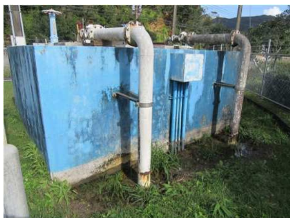
<写真－送水ポンプ井>
