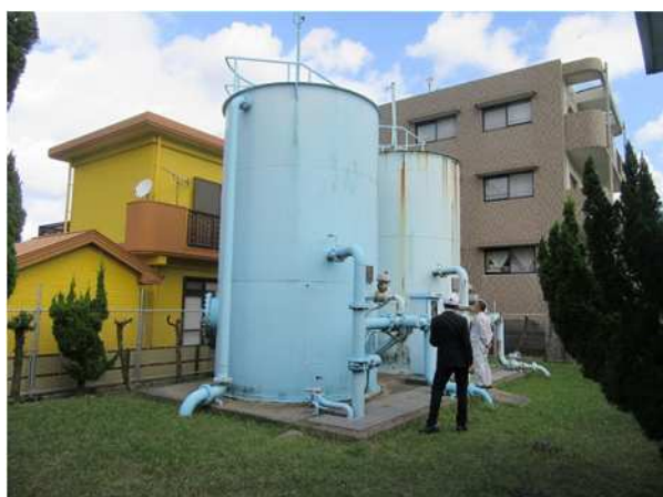
<写真－除Fe・Mn機のようにす>
