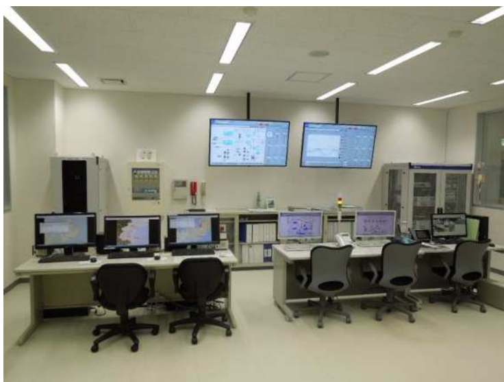
<写真－中央監視室のようす>
