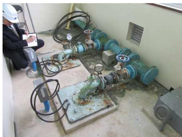
<写真－送水ポンプのようす>
