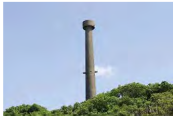
赤尾木送受信所コンクリート柱
