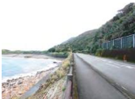
構造物が生物の移動を阻害
